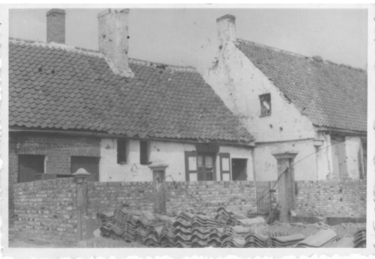
Het ovenkot en een deel van het woonhuis geteisterd door kogelgaten.
