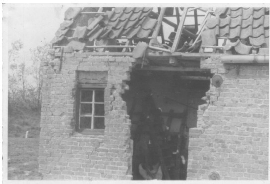
Dichtst tegen de brughelling was ook de maalderij getroffen.
