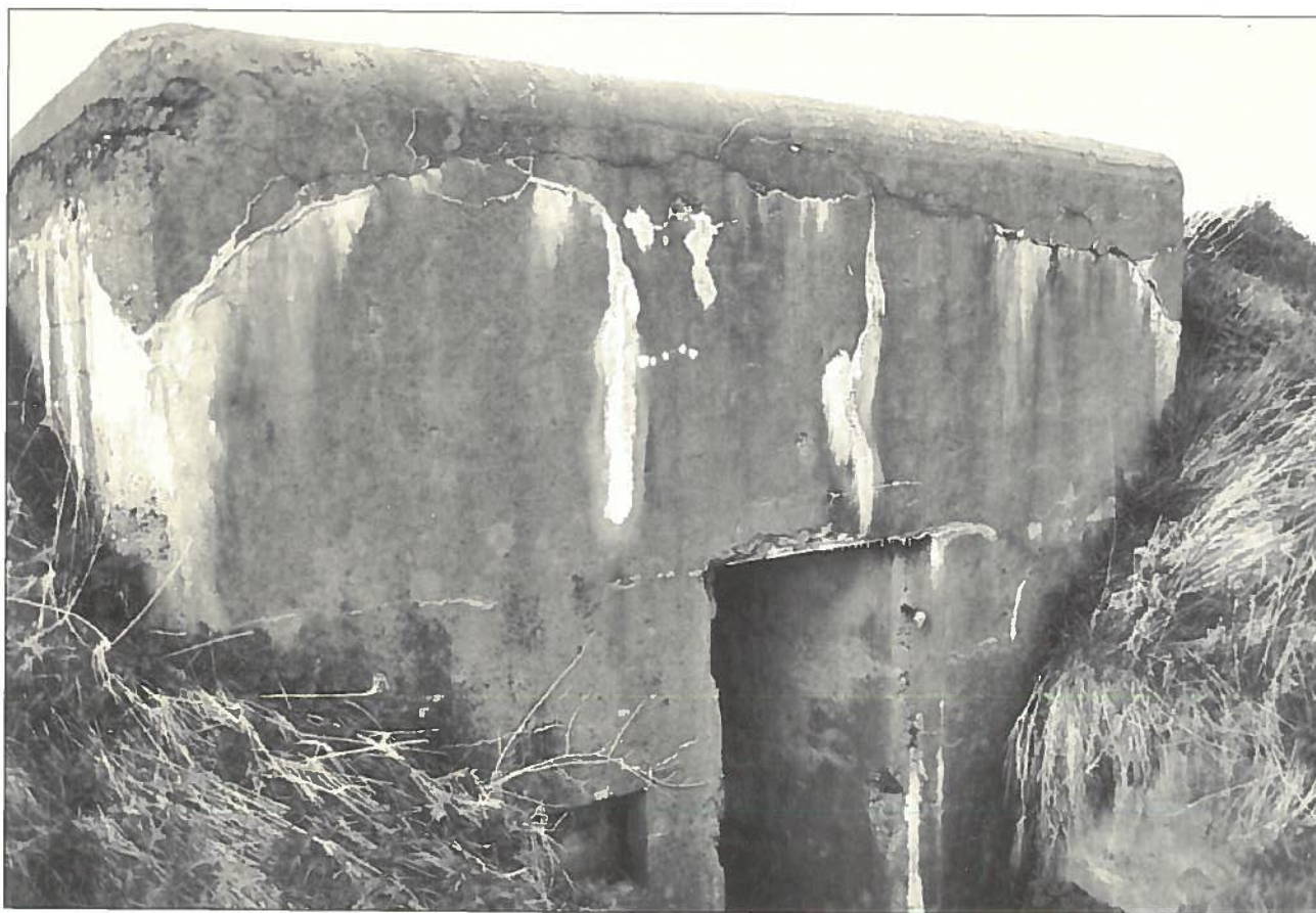
De voorkant van de KSS bij het 'Zwart Huis', bij dit type was de ingang normaal 1,50 meter hoog. Links de nis voor de externe connectie. Veldeenheden van het leger konden daar hun veldtelefoons aansluiten op de bestaande lijnen.
